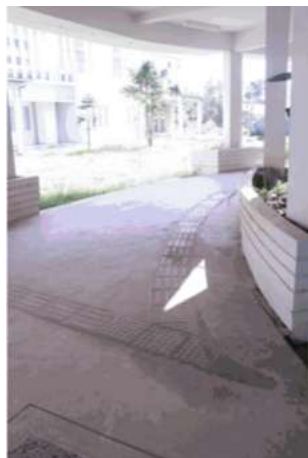
Gambar 9. Jalur pengguna difabel buta dengan arah yang tidak jelas
