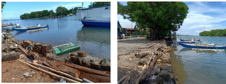
Gambar 8. Konstruksi penahan tanah yang cenderung terlepas dari ikatan pasangan specie
