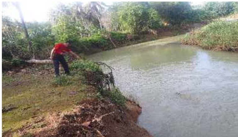
Gambar 5. Longsor akibat banjir
