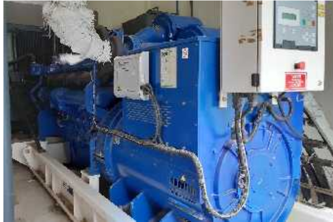
(a) Ruang Genset/PLTD Fakultas Teknik
