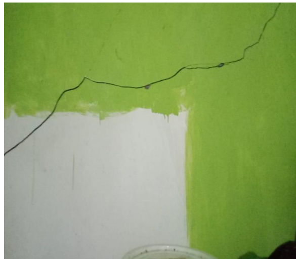
Gambar 12. Percontohan Kasus Rumah Warga Desa Balang-Balang yang Mengalami Keretakan pada Dinding yang Panjang dan Penggunaan Konstruksi Atap Baja yang Tidak dilengkapi Angkur sebagai Penahan Angin
