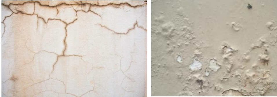
Gambar 8. Ilustrasi Kerusakan Dinding Akibat Dampak Banjir (Sumber: http://edupaint.com/cat/427 )
