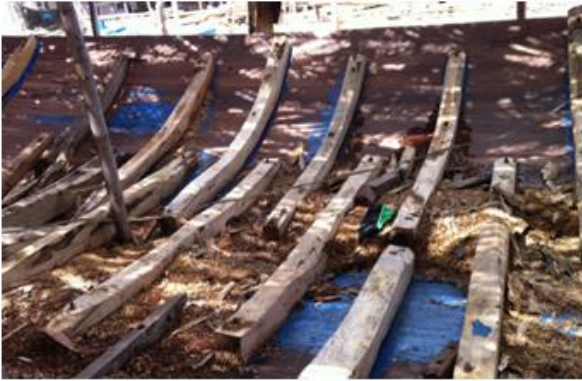
Gambar 3. Lingkungan yang kotor di atas struktur dasar dari proses pembangunan kapal kayu di sebuah galangan kapal kayu ( unsafe condition )
