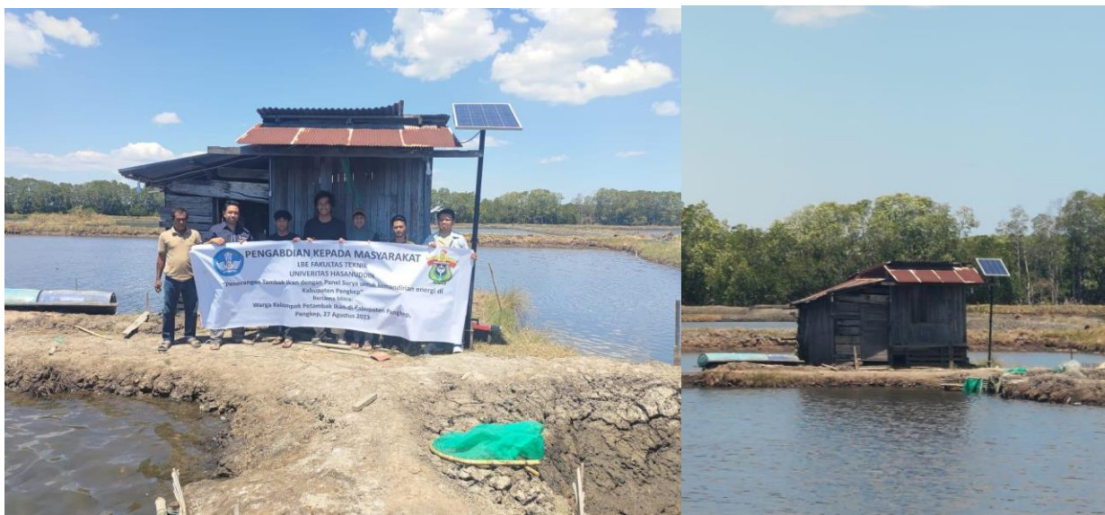
Gambar 4. Pemasangan Sel Surya untuk Penerangan Tambak Warga di Kampung Turungan Bontojai
