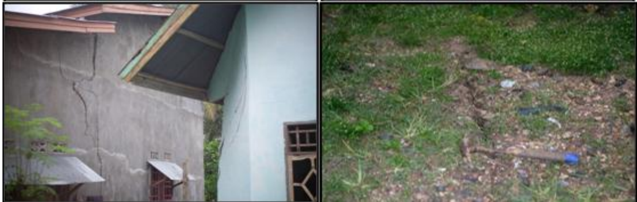
Gambar 4. Pergeseran tanah dan Retakan rumah pada Daerah Borong
