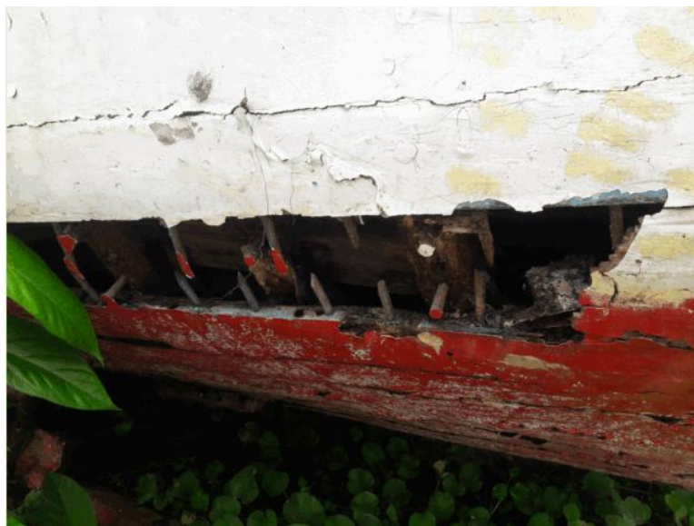
Gambar 1. Kerusakan Papan Kulit Kayu di Galesong
