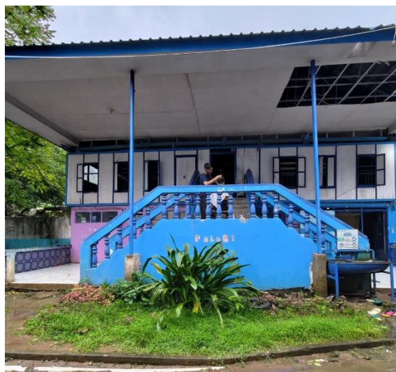
Gambar 2. Eksisting Bangunan yang akan Diredesain menjadi Aula Pesantren Darul Aman Gombara Makassar
