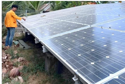
Gambar 2. Kondisi Fisik Panel Surya Induk yang Sudah Tidak Berfungsi
