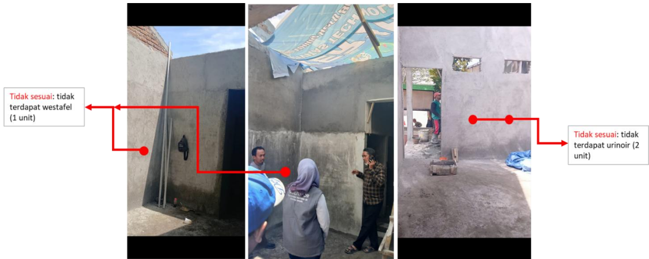
Gambar 3. Kondisi Awal Fasilitas Toilet SMAN 10 Gowa yang Belum Memenuhi Ketentuan Juknis Saat Tinjauan/Verifikasi Lapangan
